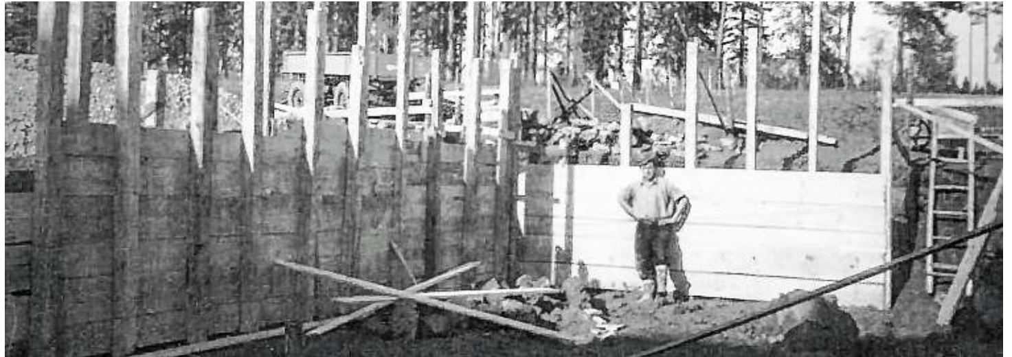
Fast alle Gebäude in Eisenbach tragen die Handschrift der Baufirma Demattio. Hier entsteht das Wasserreservoir in Oberbränd. BILDER: ARCHIV DEMATTIO
