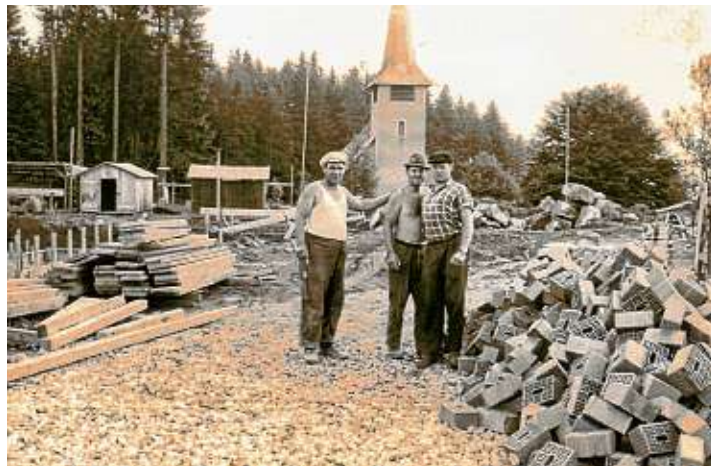
Ein Unternehmen, ganz eng verwurzelt mit dem Ort. Hier baut die Baufirma Demattio den Kindergarten in Oberbränd.
